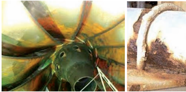
Figura 12.3. Corrosión en centrales hidroeléctricas accionadas con aguas anóxicas. ( www: source=univybtm=ischyq=corrosion+centrales+eléctricas+hidroelectricas+imágenes )
